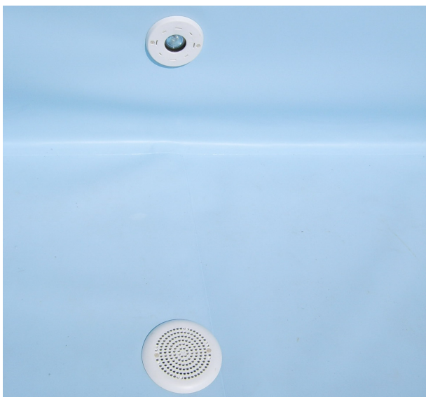
Abbildung 19: Anschlüsse im Pool
